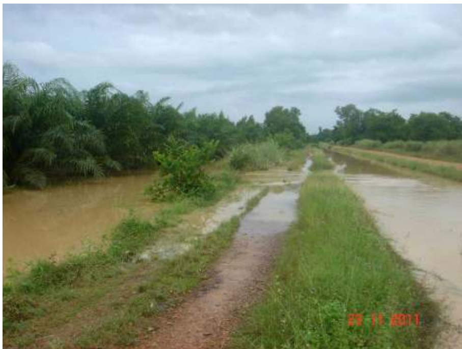
ถนนคันคลอง 1R-RMC ช่วง กม.0+500 – 2+600 อ.ไชยา จ.สุราษฎร์ธานี น้ำท่วมสูงประมาณ 30 ซม. ถ่ายเมื่อวันที่ 23 พฤศจิกายน 2554
