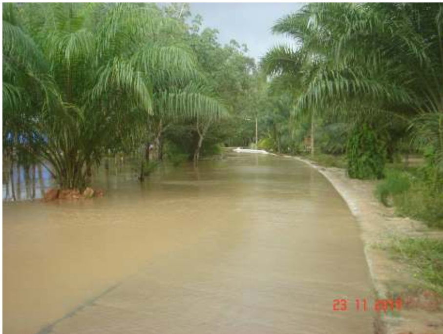
อบต. ท่าหิน - คลองชลประทาน 1L-RMC หมู่ 1 ต.เวียง อ.ไชยา จ.สุราษฎร์ธานี น้ำท่วมถนนคอนกรีตสูงประมาณ 20-30 ซม. ถ่ายเมื่อวันที่ 23 พฤศจิกายน 2554
