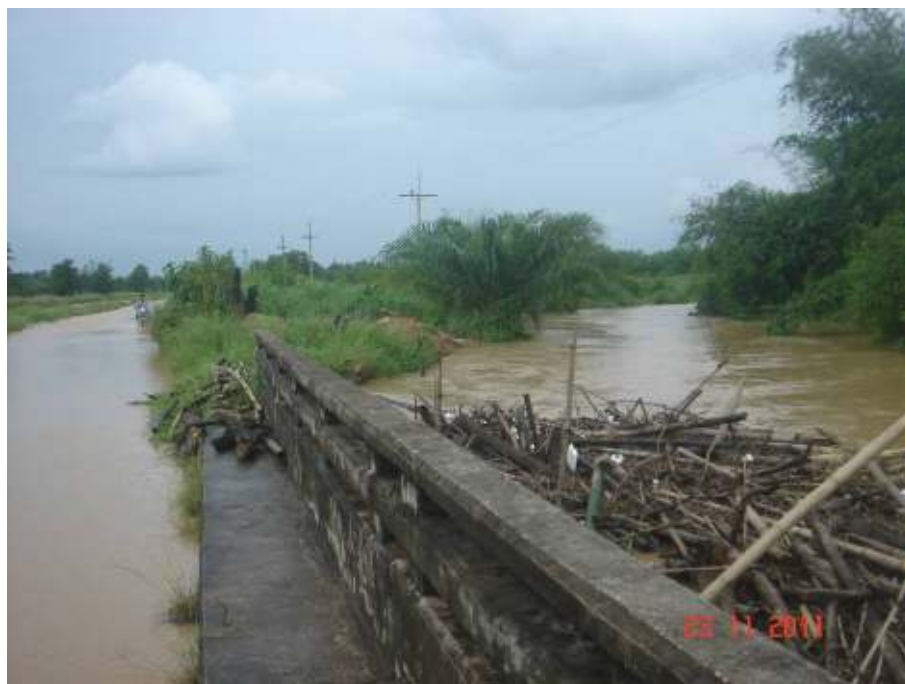
สภาพน้ำเต็มคลองปากด่าน (ด้านหน้า) หมู่ 3 ต.เวียง อ.ไชยา จ.สุราษฎร์ธานี ถ่ายเมื่อวันที่ 23 พฤศจิกายน 2554
