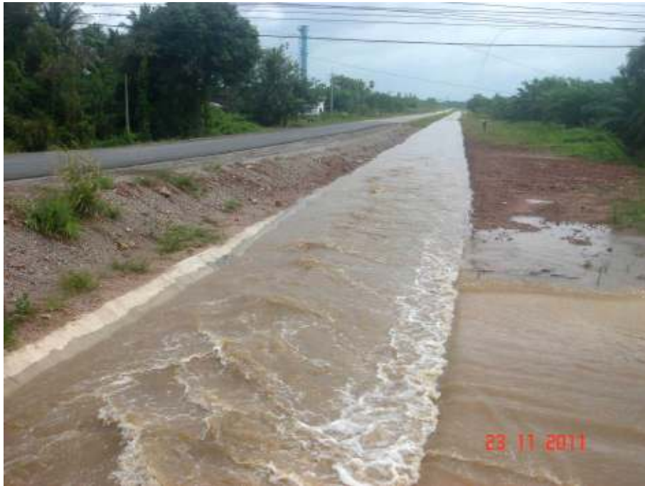
คลองส่งน้ำ RMC กม.7+700 หมู่ 3 ต.เวียง อ.ไชยา จ.สุราษฎร์ธานี น้ำท่วมสูงประมาณ 10 ซม. ถ่ายเมื่อวันที่ 23 พฤศจิกายน 2554
