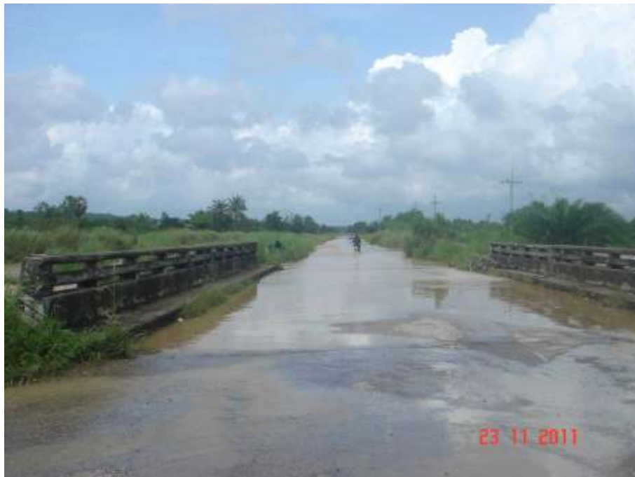
ถนนลาดยางคลอง RMC ช่วง กม.7+900 - 8+300 อ.ไชยา จ.สุราษฎร์ธานี น้ำท่วมผิวจราจรสูงประมาณ 30 ซม. ถ่ายเมื่อวันที่ 23 พฤศจิกายน 2554
