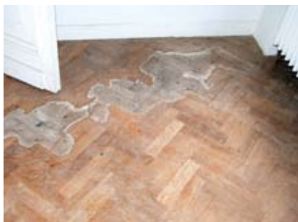
Watervlekken onder een lekkende radiator met vorming van ijzertannaat rond de nagels in het hout
