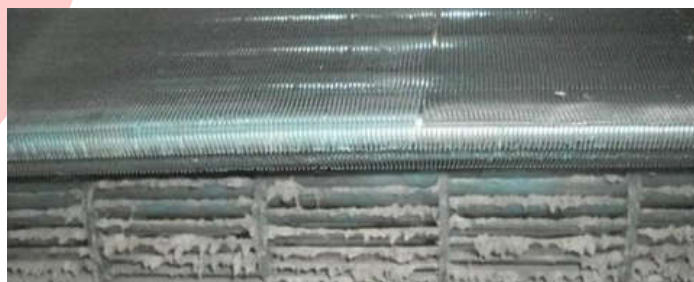
SERPENTINA E VENTILADOR (SUJO)
