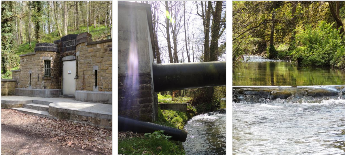
Figure 71 : Pompage CIBE ; Canalisation passant au-dessus du Triffoyo ; Ruisseau de Triffoyo
