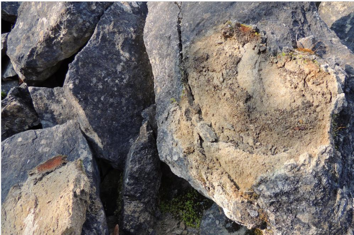
Figure 64 : Pierre bleue friable sous la main
