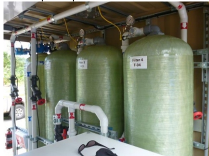
Batería de cuatro filtros en serie conectados con un sistema de retro lavado.
