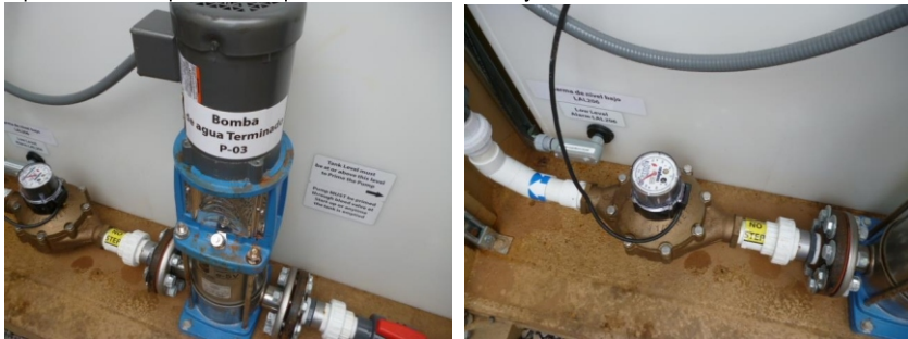
Bomba con bifurcación al retro lavado y hacia el tanque de almacenamiento. Cuenta con medidor de caudal producido.
