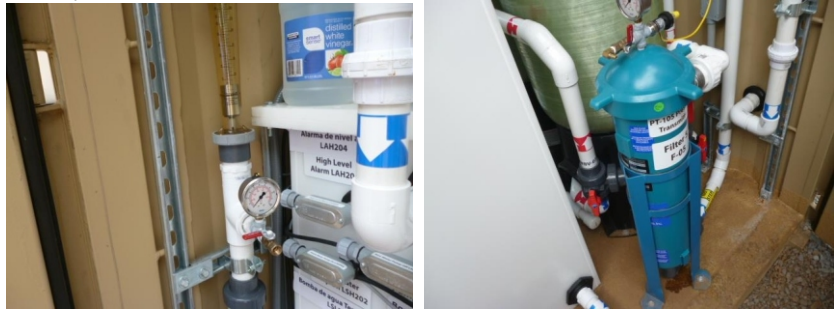
Medidores de presión que determinan el momento adecuado para el retro lavado y quinto filtro para momentos de alta turbiedad del agua cruda en la toma.
