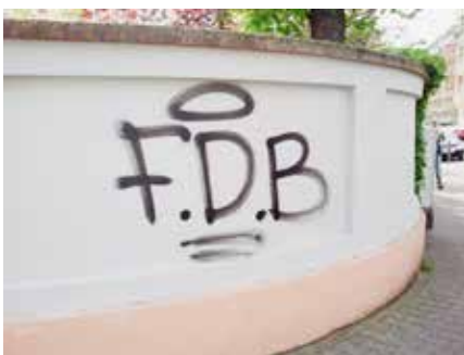
Farbanschlag auf geschützten Untergrund
