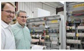
Die SKM-Geschäftsführer Rolf Spremberg (links) und Thomas Menze zeigen einen typischen Schaltkasten aus ihrer Fertigung. Fotos: Chadde
