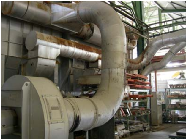
IMPIANTO ABBATTIMENTO FUMI ↓
