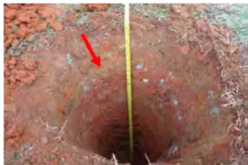
Foto 9.3.2.9-3: Poço teste 008 finalizado, sendo possível observar os níveis de aterro na área assinalada, com as coordenadas UTM 23K 0363924 / 7404638.
